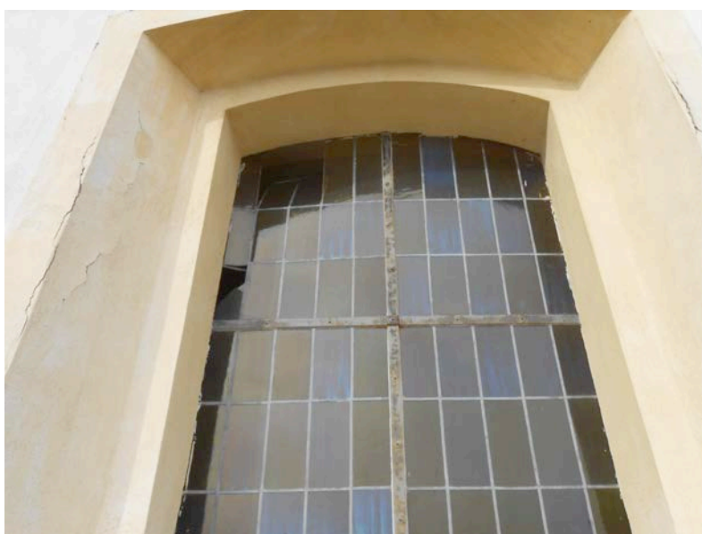
Foto č.15: Porušené okno na jižní stěně hlavní lodi
