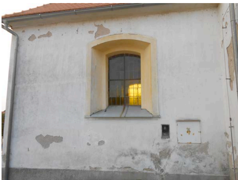
Foto č.20: Vzlínající vlhkost ve zdivu presbytáře
