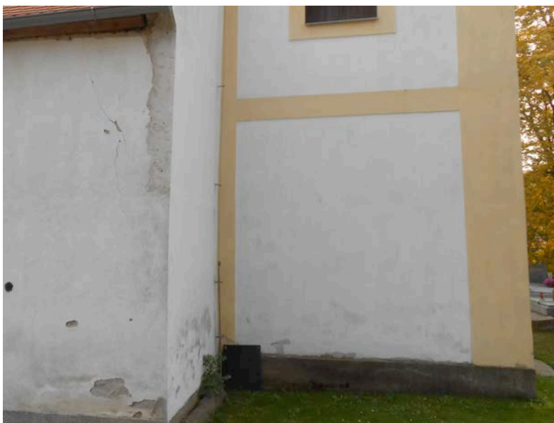
Foto č.25: Vzlínající vlhkost zdiva patrná na nové fasádě věže
