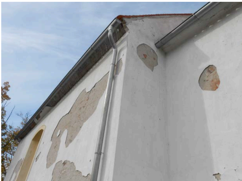
Foto č.23: Poruchy fasády a říms hlavní lodi a presbytáře
