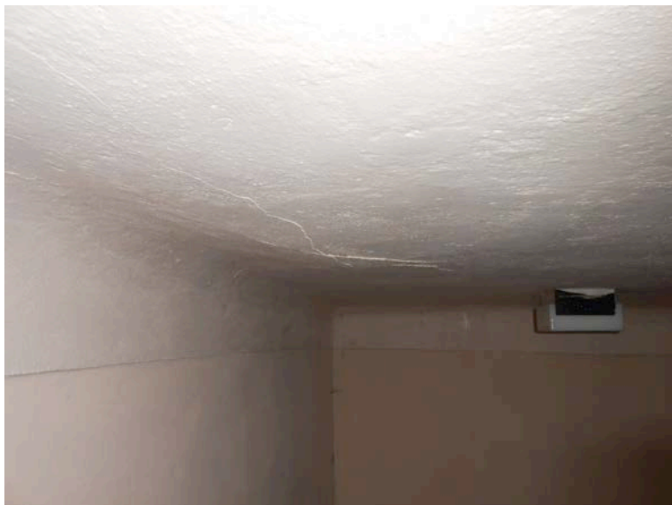
Foto č.19: Prasklý a pokleslý stropní pohled nad kůrem
