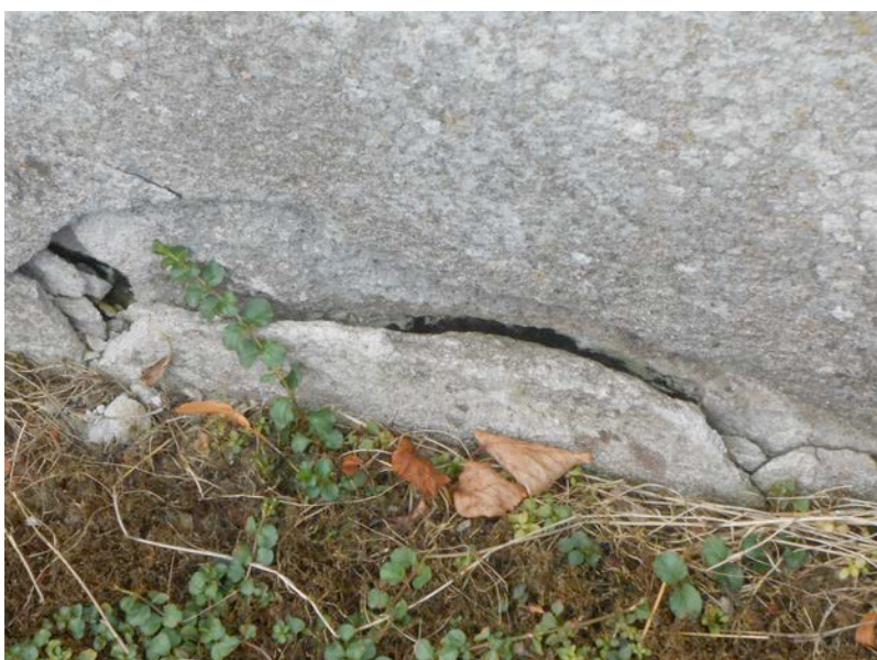
Foto č.24: Poruchy soklu hlavní lodi (stejný problém je i na římsách presbytáře)
